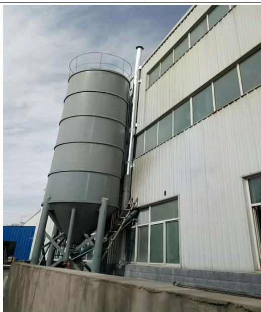
水泥仓、干粉砂浆生产线 16m 排气筒
